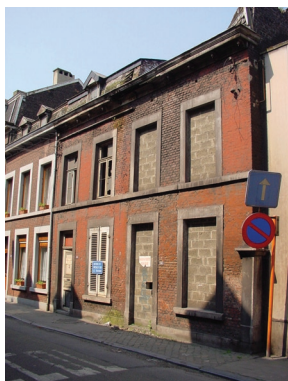
Comprendre et analyser les causes de la dégradation
