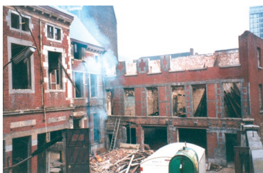
L'état de dégradation de l'ancien couvent des Ursulines a nécessité des travaux de grande ampleur...
