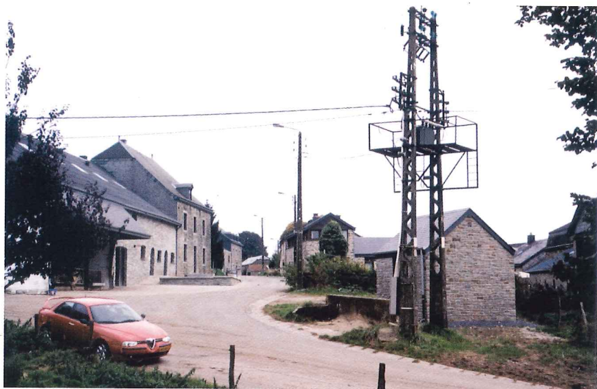
Une amélioration sensible du cadre bâti a été obtenue ici, à Jenneville (Libramont), par le démontage du poste de transformation aérien au profit de son installation dans une nouvelle cabine électrique, discrète, visible derrière le double pylône. (document Interlux)
