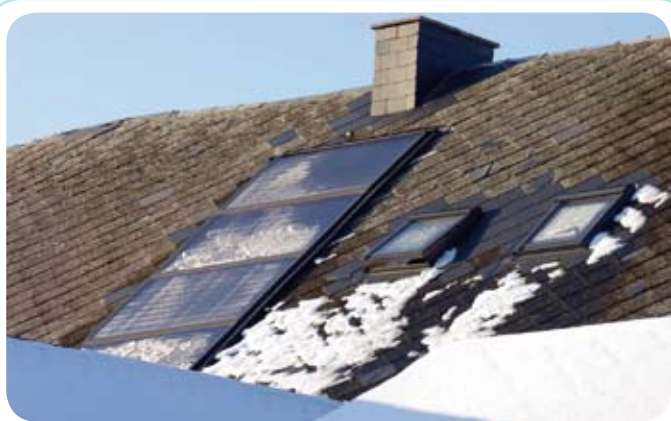
Légende Panneaux solaires thermiques sur une toiture de bâtiment traditionnel à Ohey.
